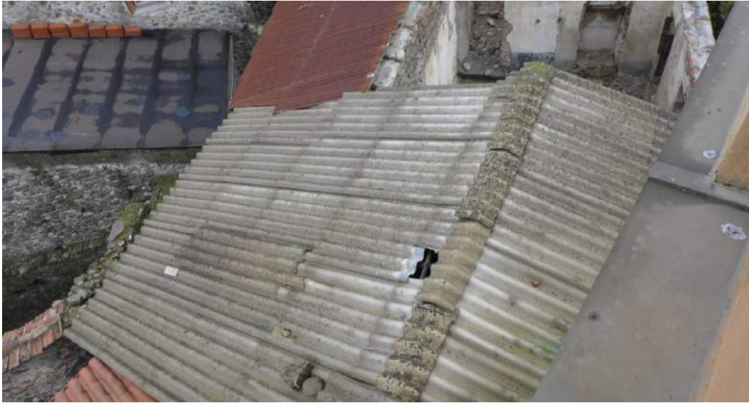
47. La provvisoria copertura dell'unità abitativa su vicolo della canonica da sostituire.
