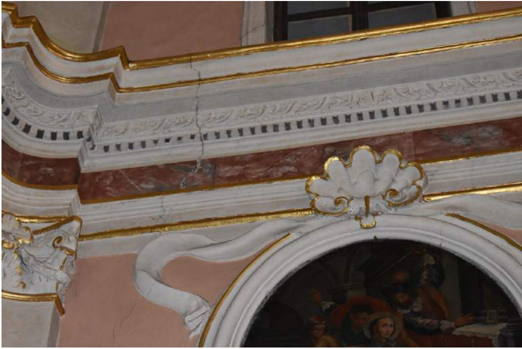
11. Le lesioni della parte alta, prima campata, navata centrale lato sinistro in corrispondenza delle quali si inserirà il rinforzo con la barra C6.
