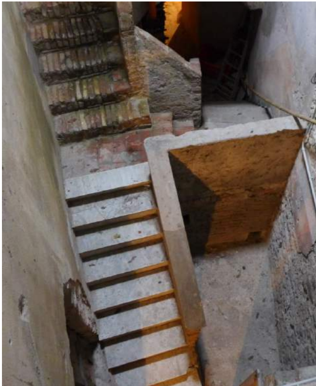
37. La scala C: la rampa di recente fattura in basso in foto sarà demolita per proseguire il tratto di più antica costruzione e garantire una logica relazione tra gli spazi.
