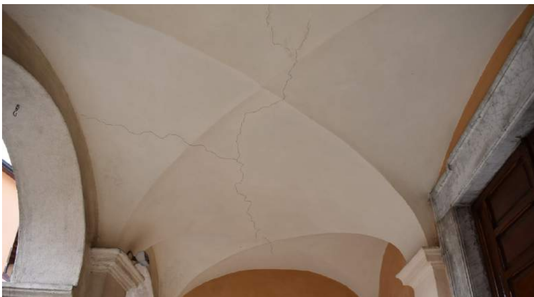
10. Le lesioni delle volte del portico che precede l'ingresso alla chiesa presbiterio in corrispondenza delle quali si inseriranno le catene C3 e C4.
