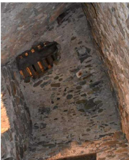
6. Porzione mancante della volta del campanile da ripristinare.
