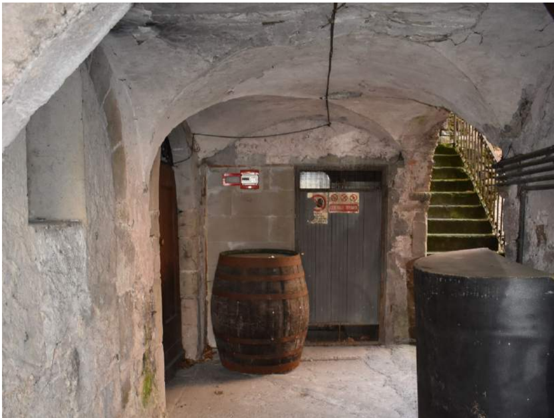
25. L'ingresso al locale che ospita la centrale termica che si trova al termine del passaggio coperto; con lo smantellamento dell'impianto nel locale verrà realizzato lo scivolo che consentirà il raggiungimento dell'ascensore e, di conseguenza, tutti i locali del complesso parrocchiale.
