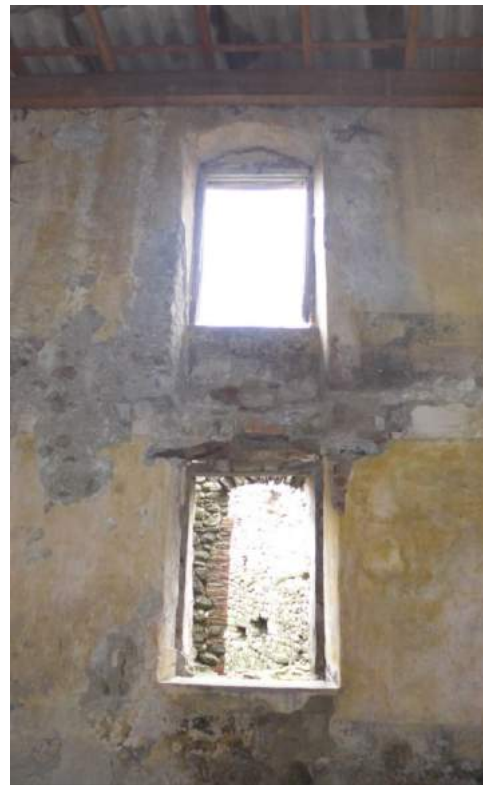
46. Uno dei due muri perimetrali dell'unità sul quale si aprono le due finestre, è possibile intravedere il livello del vecchio solaio che verrà ricostruito assieme alla relativa scala.
