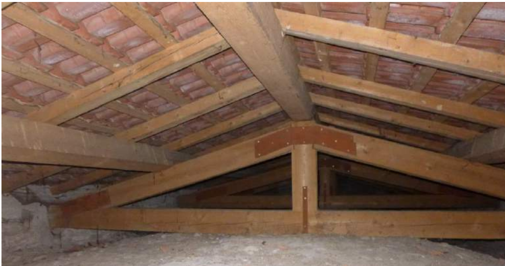
4 – 5. La copertura e il sottotetto della chiesa (travetti da integrare)
