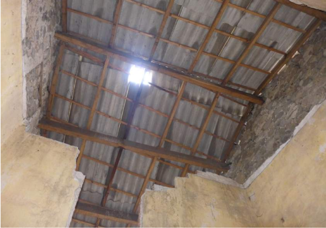
44. La provvisoria copertura in lastre ondulate dell'unità abitativa da sostituire con una nuova struttura del tetto in legno.
