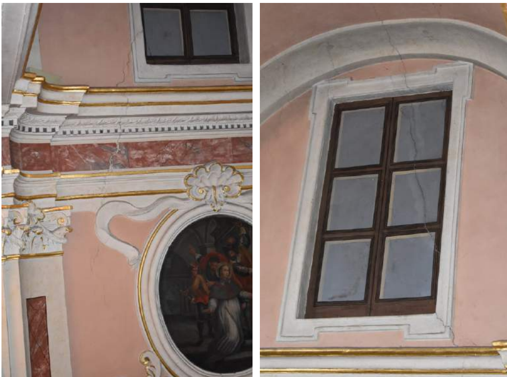
12-13. Le lesioni della parte alta, prima campata, navata centrale lato destro in corrispondenza delle quali si inserirà il rinforzo con la barra C5.
